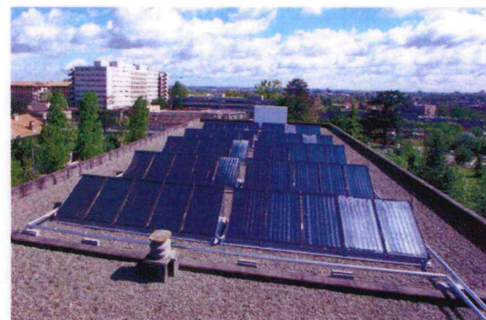
Capteurs solaires destinés à la production d'eau chaude sanitaire pour un hôtel.
